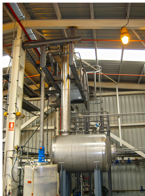
Instalación de abatimiento de metanol con recuperación posterior.
